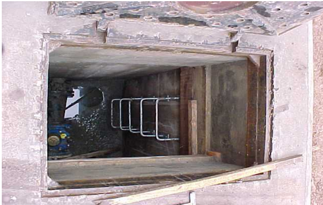
Acceso a cámara de medición – Central Dock Sud
